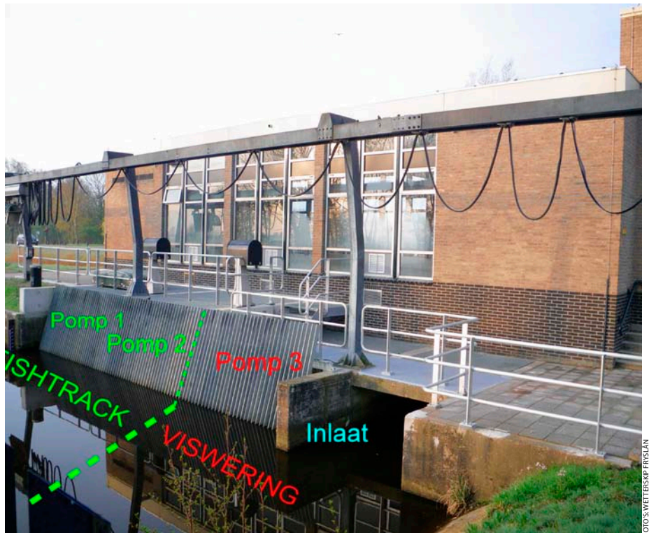
Situering van de pompen in gemaal Offerhaus.
